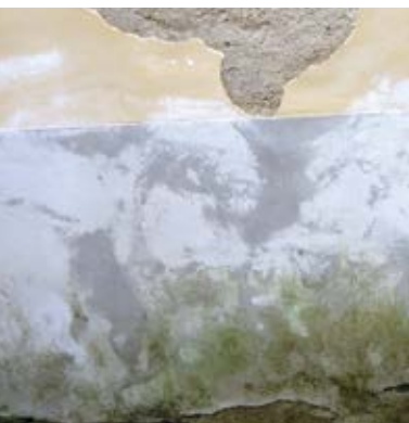
Parete con efflorescenza salina da risanare con Albusil Antisale
